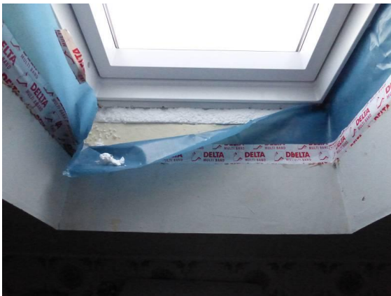
Dampfsperre nicht luftdicht angeschlossen
